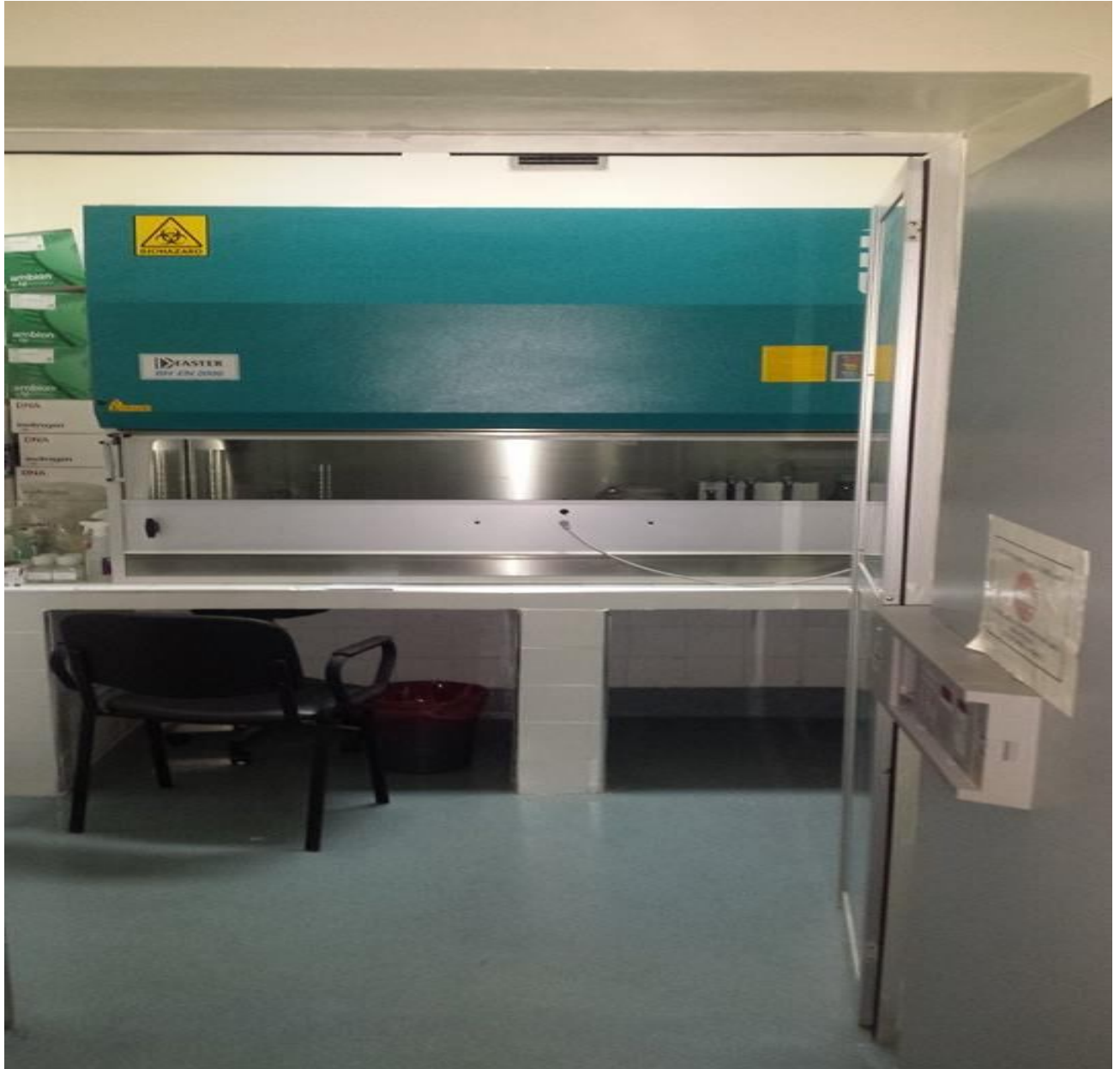
Image 10 : Salle d'extraction du Service de Microbiologie-Virologie et de biosécurité niveau 2 de l'HMA.
