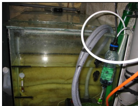
Figure 20: Bac de décantation
