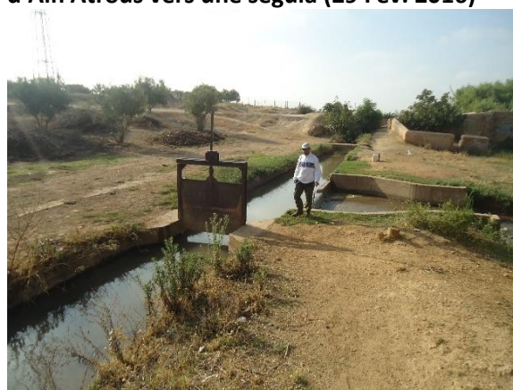
Photo 68: Dérivation des eaux de la source El Rhara vers une seguia. (8 Sep. 2016)
