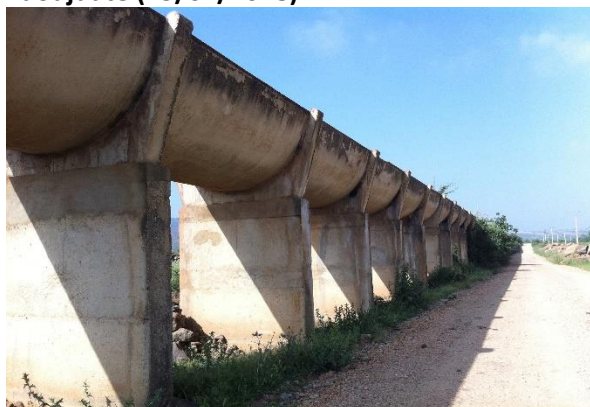
Photo 88: canal suspendu captant la source de Bittit (14/05/2016)
