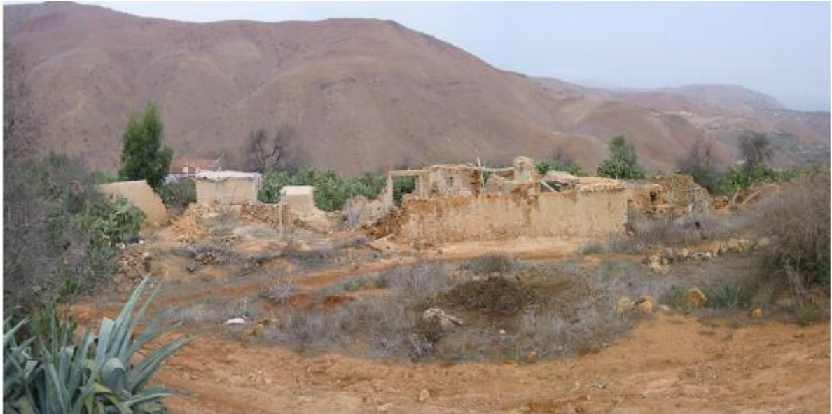
Figure 10: Principaux types de dommages des constructions en milieu rural dans la région d'Al Hoceima affectée par le séisme du 24 Février 2004. Murphy Corrella (2006).
