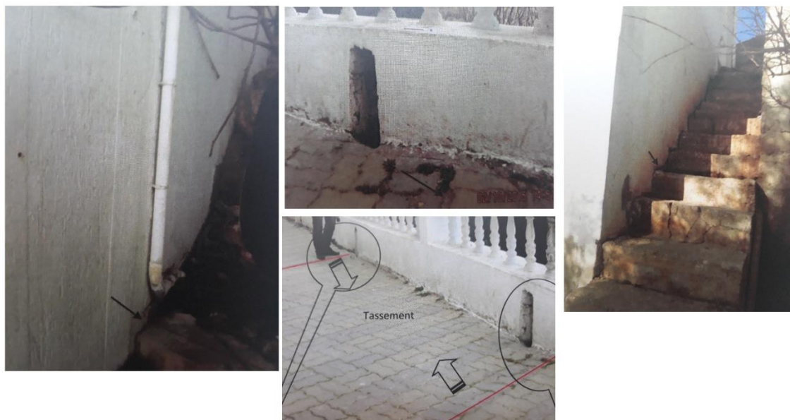
Figure 117: Suite du relevé image des désordres de la zone QUEMADO
