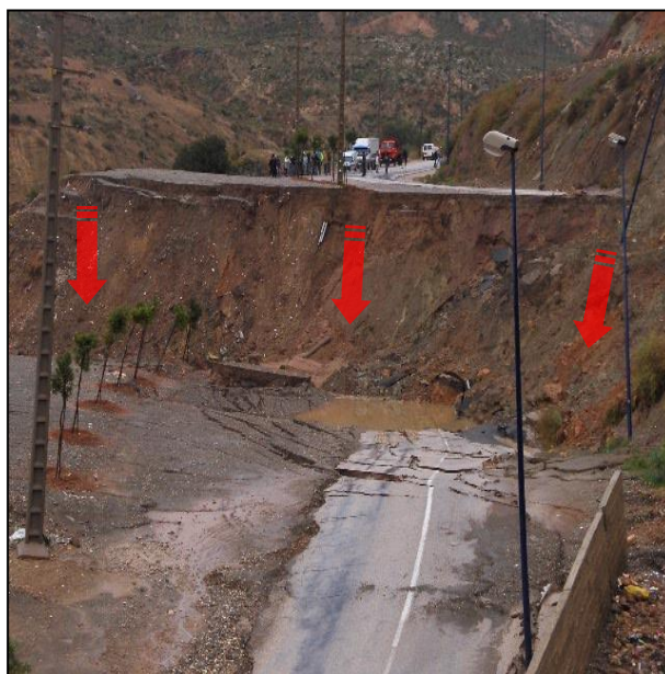
Figure 52: Affaissement et destruction de la chaussée de la route liant Al Hoceima à IZEMMOUREN
