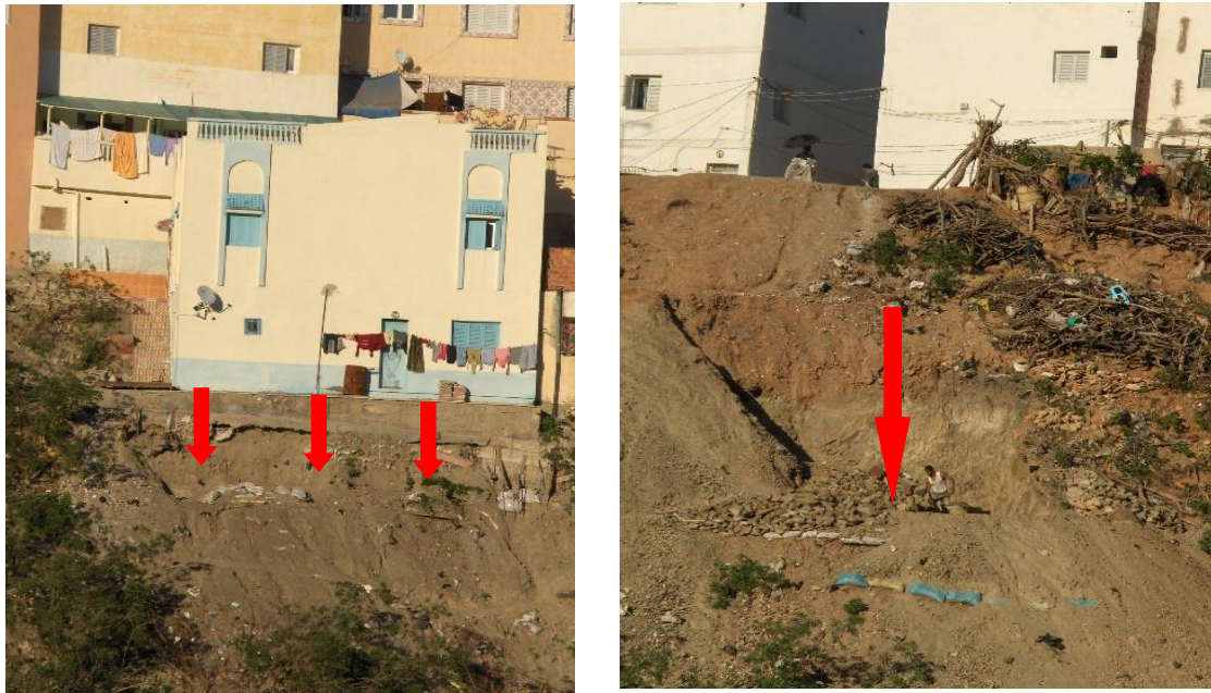
Figure 53: L'érosion continue au Quartier Mirador Haut, Al Hoceima, menace la stabilité des constructions (à gauche), Chantier clandestin en cours en dépit des dangers menaçant la stabilité du sol (à droite).
