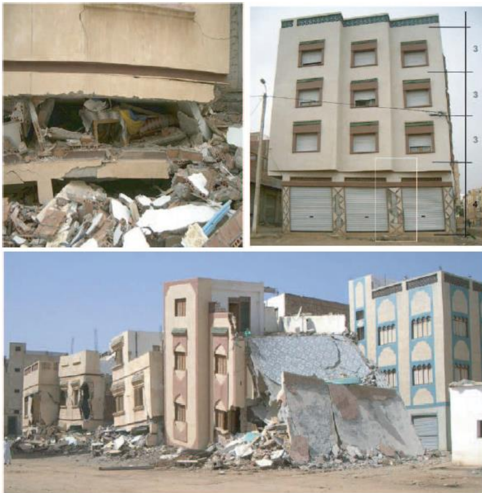
Figure 11: Principaux types de dommages des constructions en milieu urbain dans la région d'Al Hoceima affectée par le séisme du 24 Février 2004, d'après Murphy Corrella (2006).
