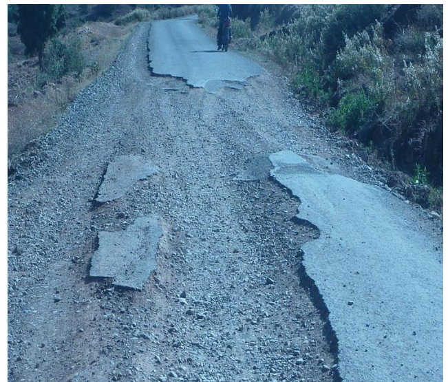
Photo 7 : dégradation de la route régionale 304 qui traverse le territoire d'Oueltana amont et mène vers Ait Bougmez
