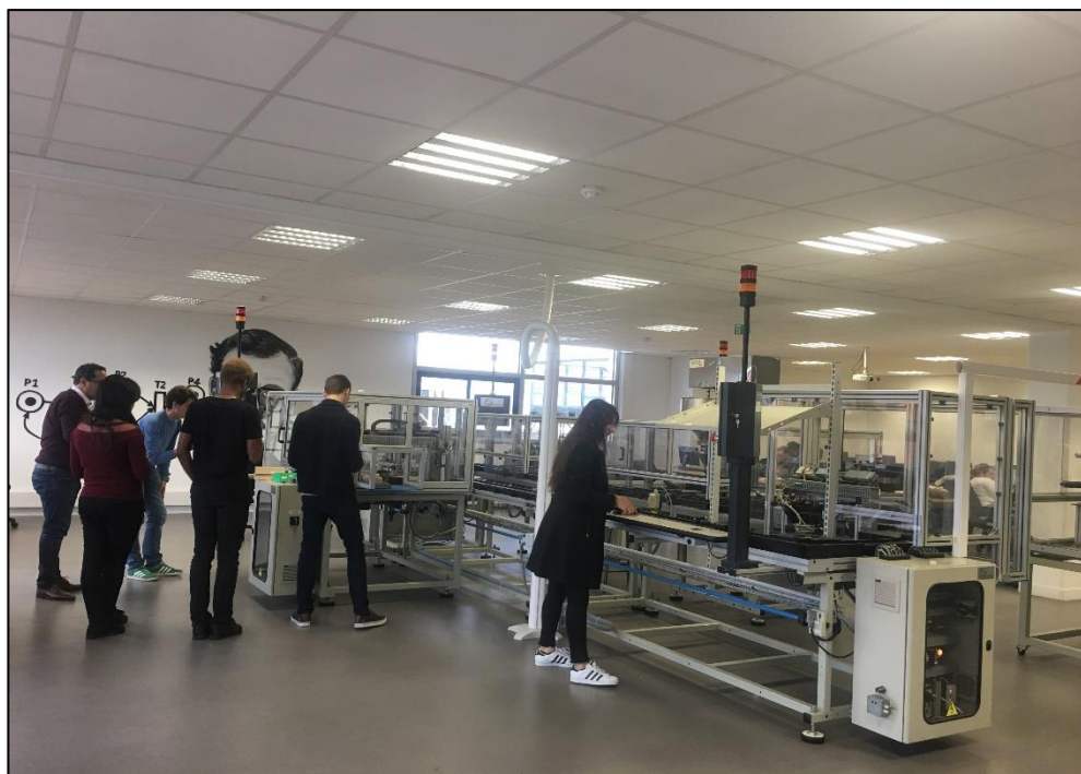
Figure A4.1 : Vue globale de la ligne de conditionnement des produits pharmaceutique
