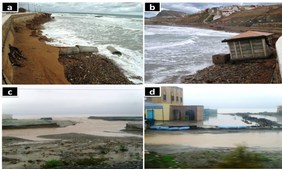
Figure IV-27. Photos illustrant les quelques dégâts suites à des houles fortes combinées aux crues fluviales A,b) Dégâts dûs à l'érosion au niveau de la zone sabadilla et Tala youssef. c,d) Inondations des constructions situées au pied de la dune au niveau de la côte de Bathou, dues à la conjonction de la houle et les crues.
