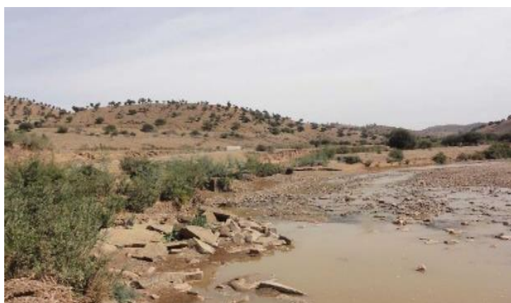
Figure 140 : Erosion de berge, en bas à gauche l'effondrement d'une digue de protection.
