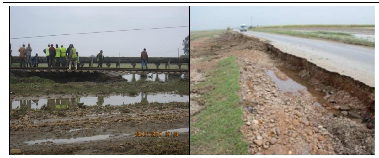
Photos. n°14: Vulnérabilité des voiries face à l'aléa d'inondation à Sidi Kacem (Ministre de l'équipement, 2010).
