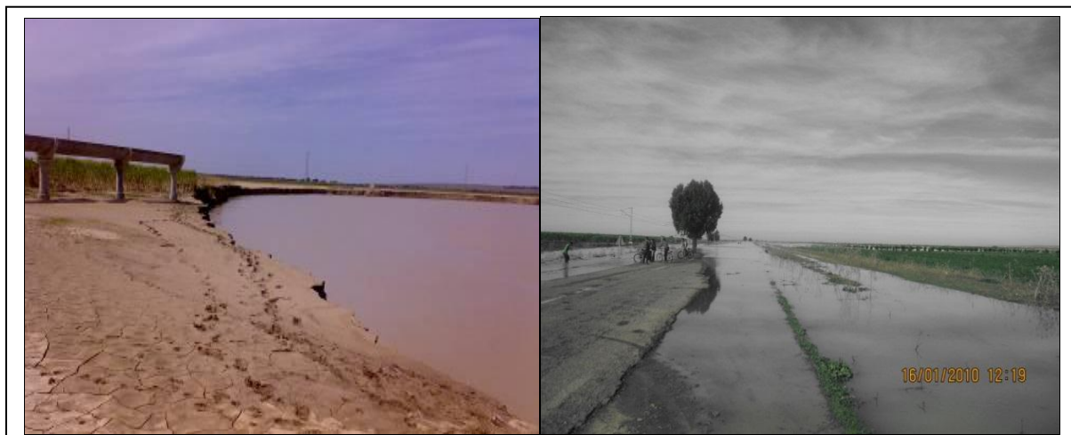
Photos. n°23: Canaux d'irrigation détruits dans la zone de Ghrarda et Coupure de la Rn°413 à M'saâda (2010).
