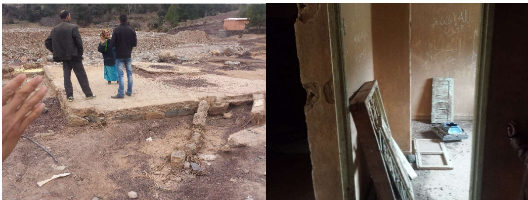
Photo 4: dégâts de l'inondation du 12 aout 2015 qui a frappé la région de Tillouguite A gauche : maison totalement détruite. A droite : école scolaire gravement touchée Coordonnées cartographiques : X= 423 672m, Y=156 054 m
