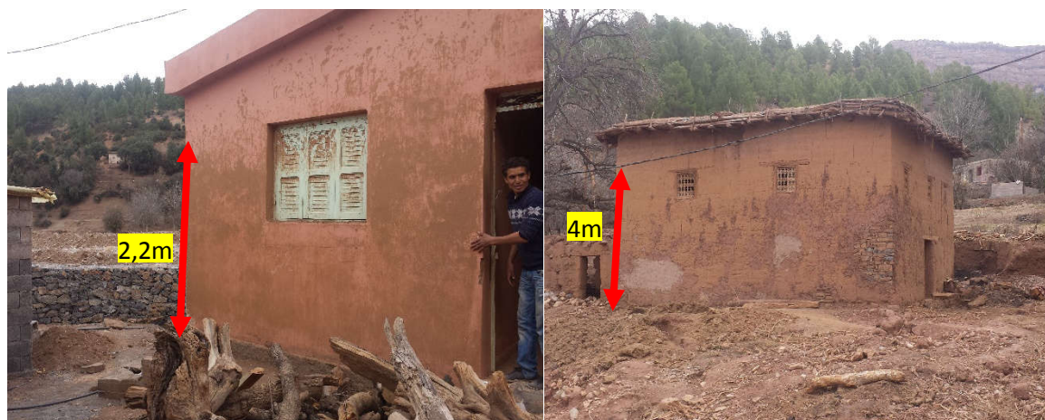
Photo 7: les traces visibles de l'événement du 15 Aout 2015 marquant la hauteur maximale de l'eau au centre d'Iminwargue, coordonnées cartographiques : X= 423 672m, Y=156 054 m
