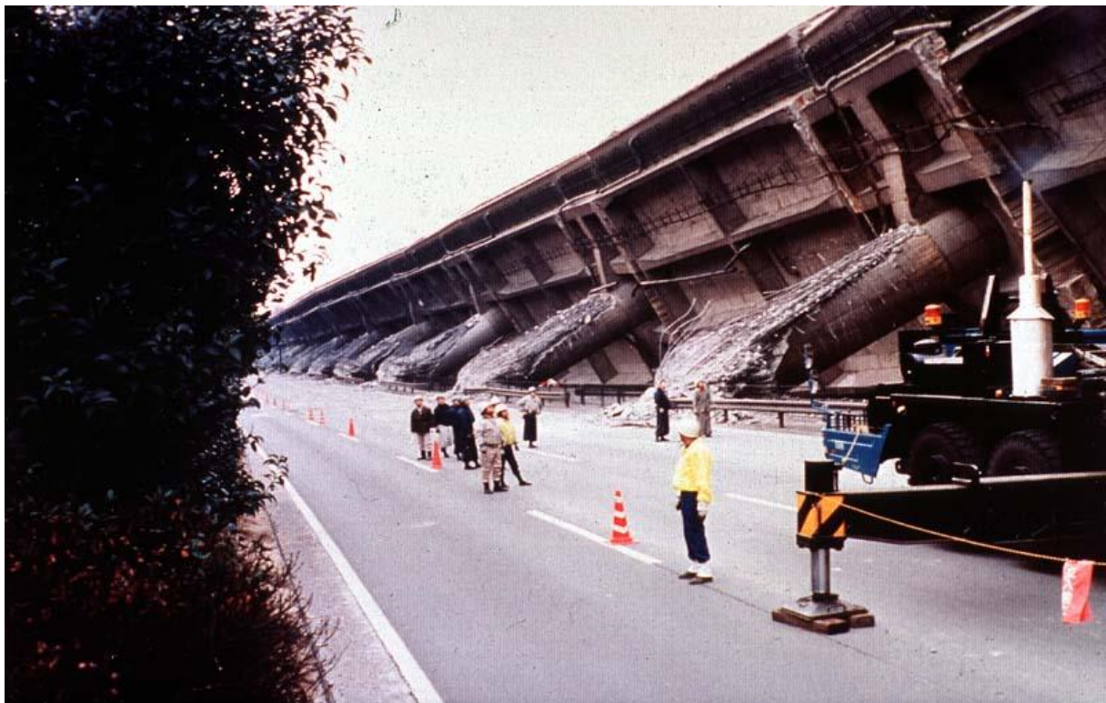
Figure 1.2 : effondrement d'un pont suite à son mouvement de pendule généré par le séisme (Séisme de Kobe)
