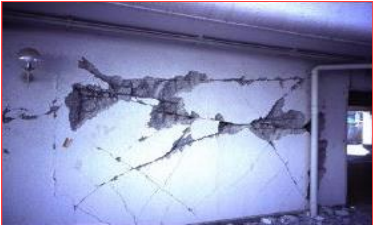
Figure 1. 1 : endommagement par fissuration d'un voile porteur
