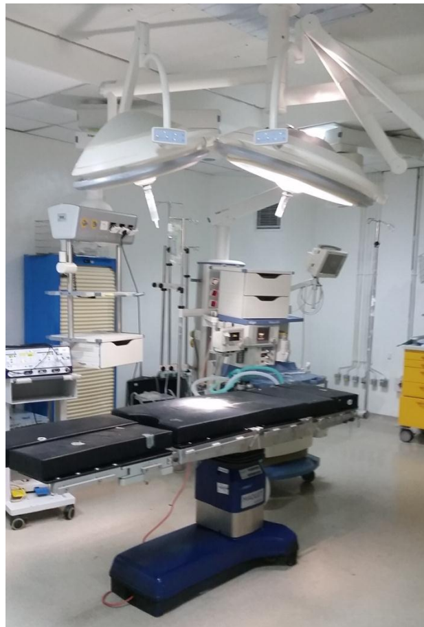
Figure 15 : Bloc opératoire (CHU Hassan II de Fès)
