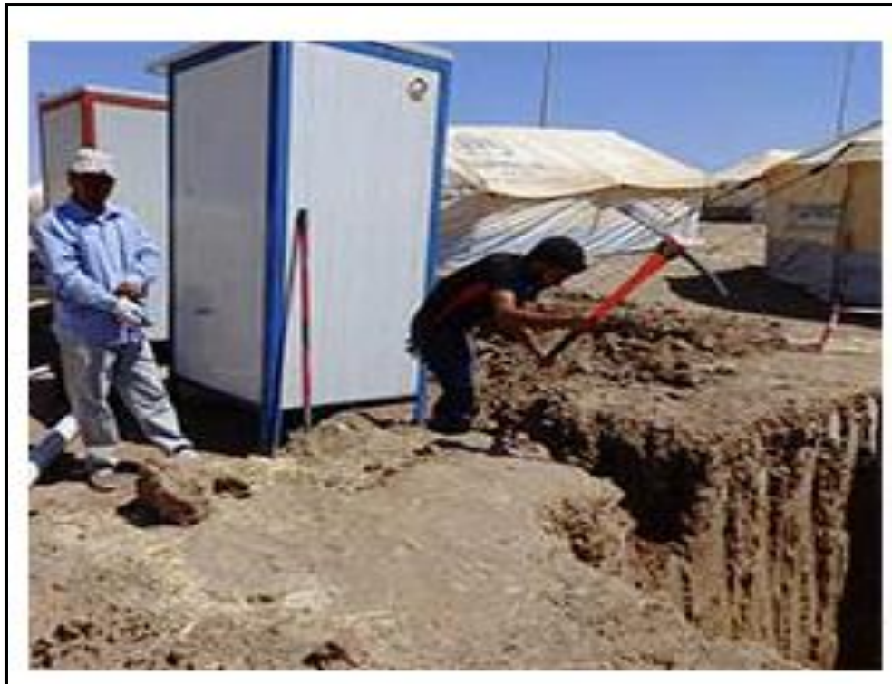
Photo 5: Mise en place de latrines dans les camps des réfugiés Syriens et Irakiens de Khanke (Source : Croix-Rouge)
