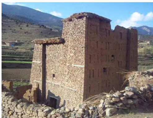
Photo 24: Erosion de toiture de Tighremt N'Ait Hammd, 2019
