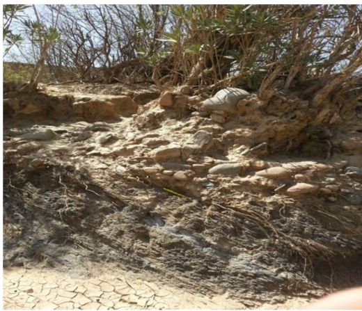
c.- Berge basse sub-verticale en rive gauche - en aval du pont RR701 (13/9/2017)
