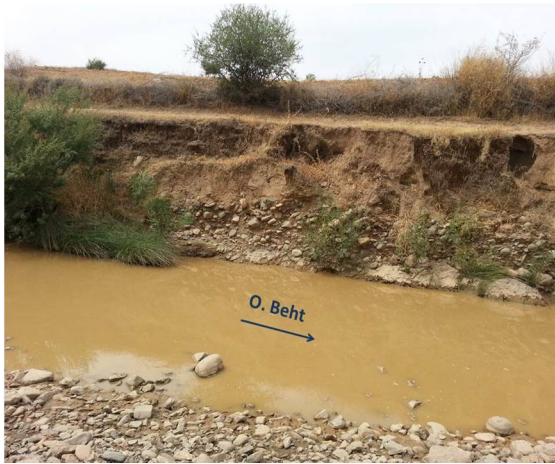
a.- Berge haute sub-verticale en rive gauche à proximité d'Ait Yahya (26/7/2016)
