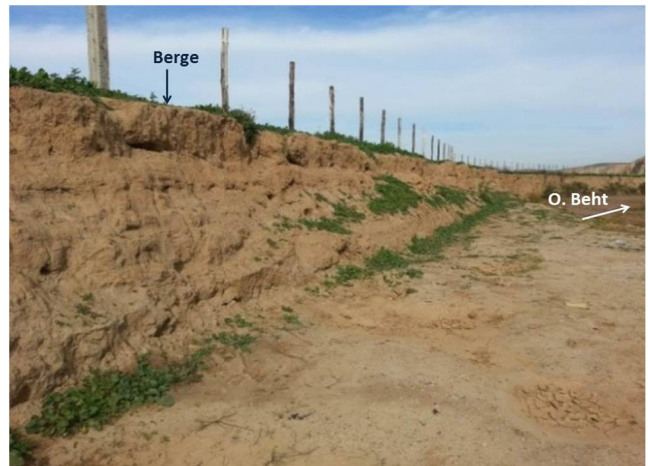
d-Berge haute, subverticale en rive gauche à Ejjaabbouja Ait Ouallal (8/1/2017)
