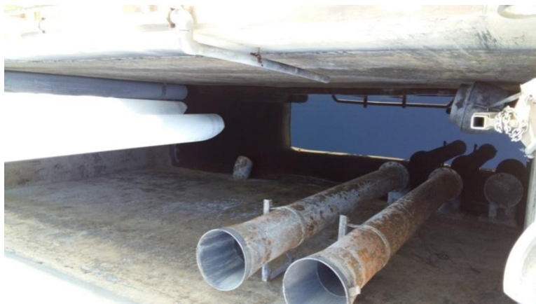
Figure 1.20. Bâche de mélanges des boues.
