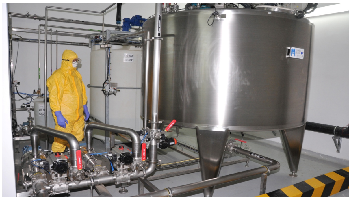
Figure 40 : station de décontamination.
