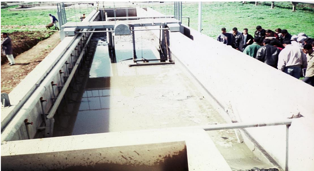
Photo 3 : Troisième étape du prétraitement (Dégraisseur et déshuileur, STEP de Béni Mellal)
