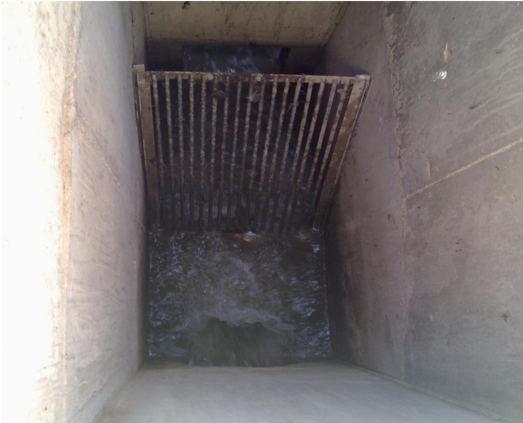
Photo 1 : Première étape du prétraitement (dégrilleur, STEP de Boujaâd)
