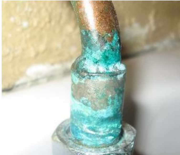
Figure 6. Formation de patine sur une conduite d'eau en cuivre
