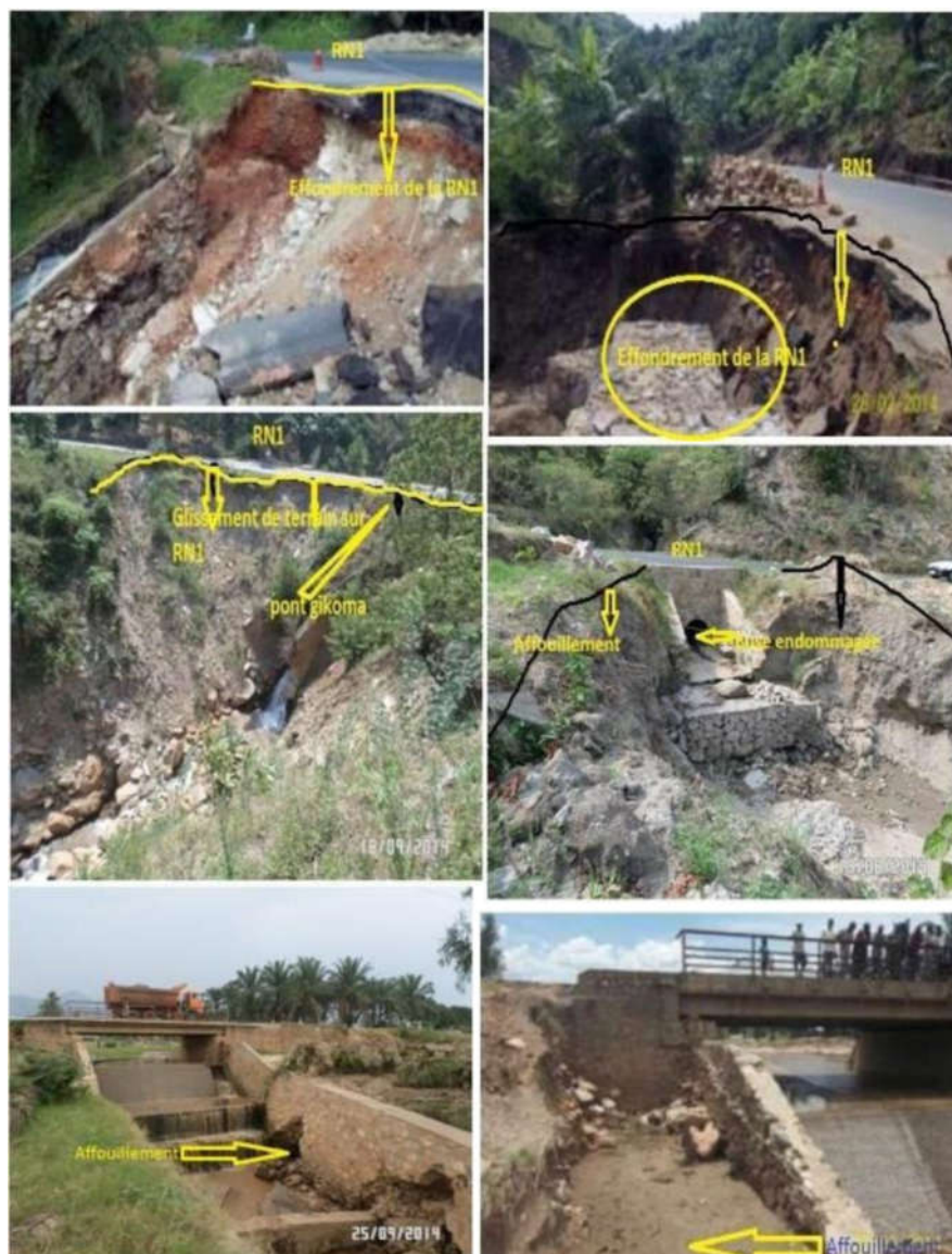
Figure IV-15: Dommages aux infrastructures de la RN 1 et la RN 9 (Photos prises et traitées par © Hermès NIYONDIKO) (ID=1284)
