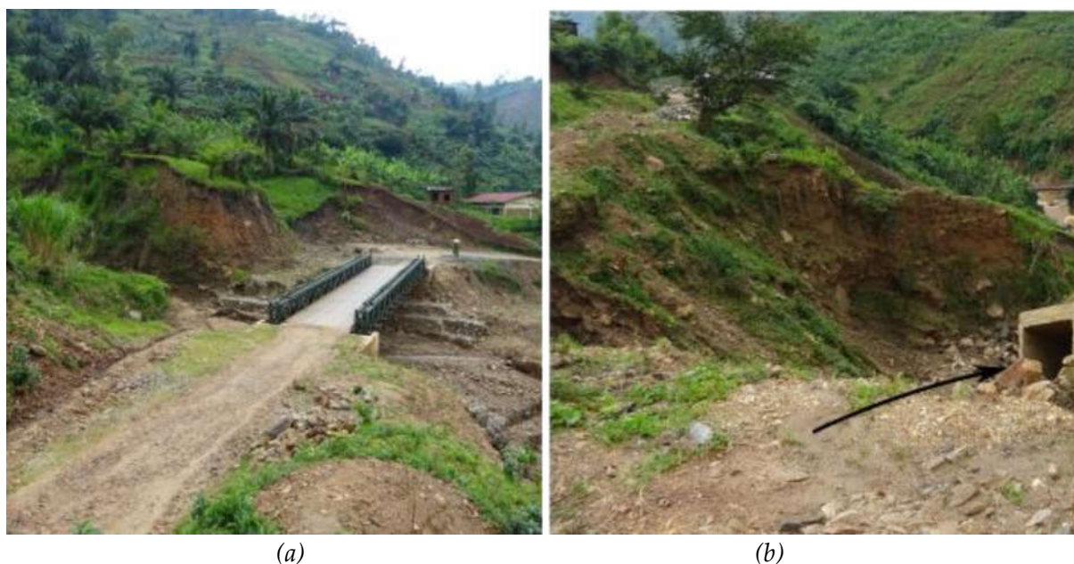
Figure IV-9: Nouveau pont (a) sur la route vers le barrage Mugere, la flèche noire (b) pointe sur la buse de pont effondré (ID=529)
