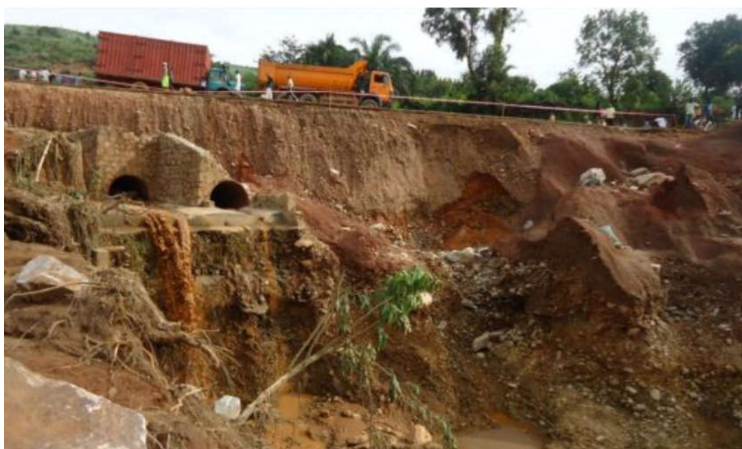
Figure IV-14: Route nationale 1 affouillée par le changement du lit de la rivière Gasenyi de la catastrophe du 10/02/2014, photo prise un jour après le drame (ID=1382)
