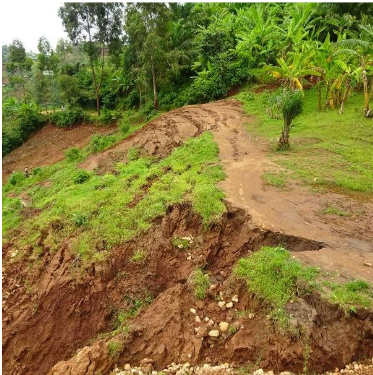
Figure IV-16: Coupure de la route communale par un glissement rotationnel dans la localité de Muyira, photo de décembre 2018 (ID=95)
