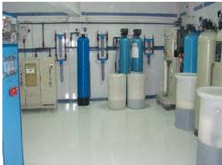
Figure 15 : Station de traitement d'eau pour hémodialyse
