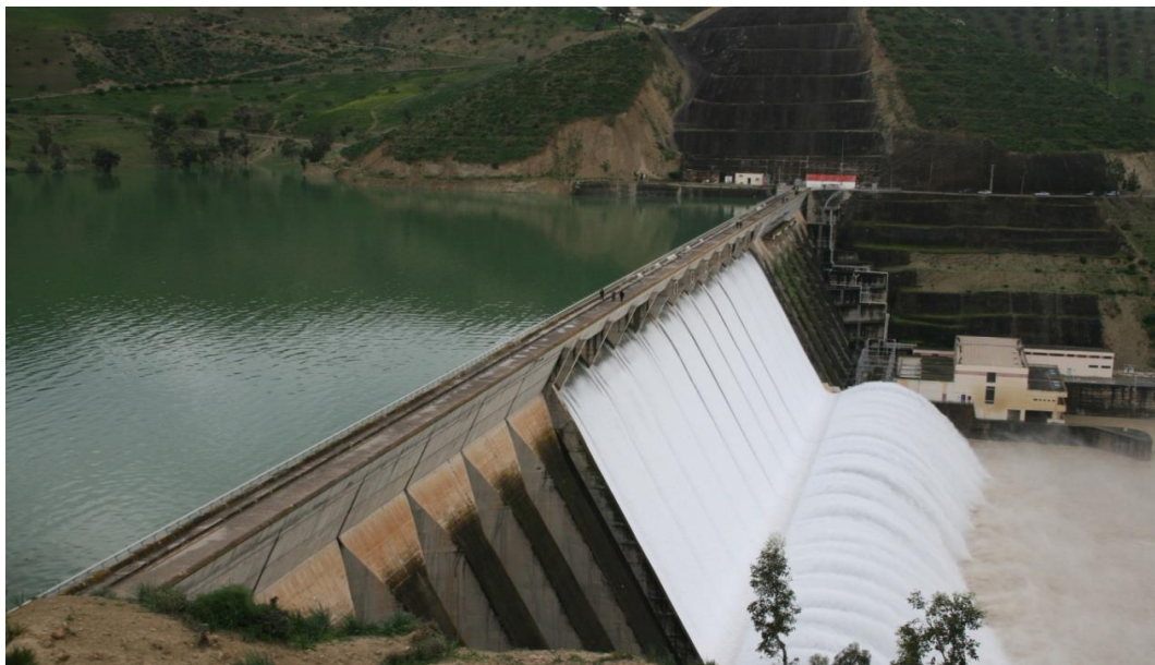
Photo 3. Déversement du barrage Idriss 1er en février 2010 (ABHS)
