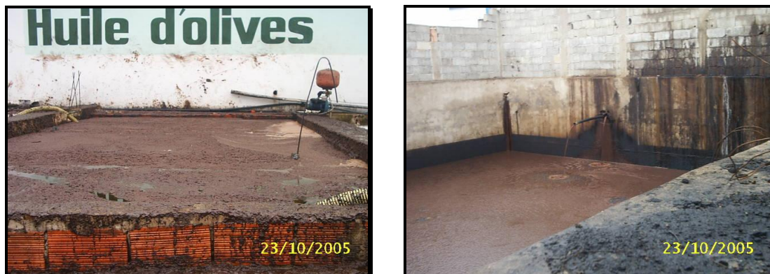
Figure 7. Photos des bassins de stockage des margines
