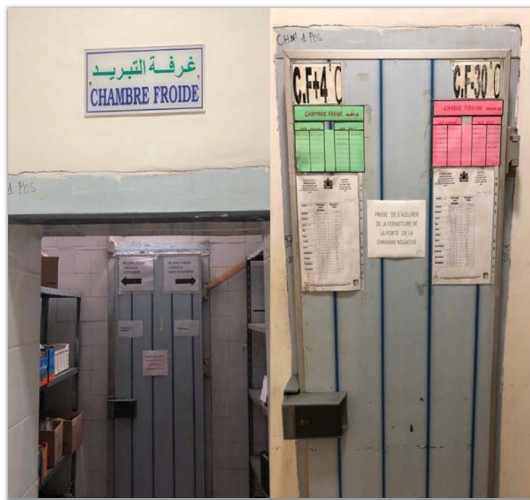
Figure 51 : Chambre froide de CRTS d'Agadir
