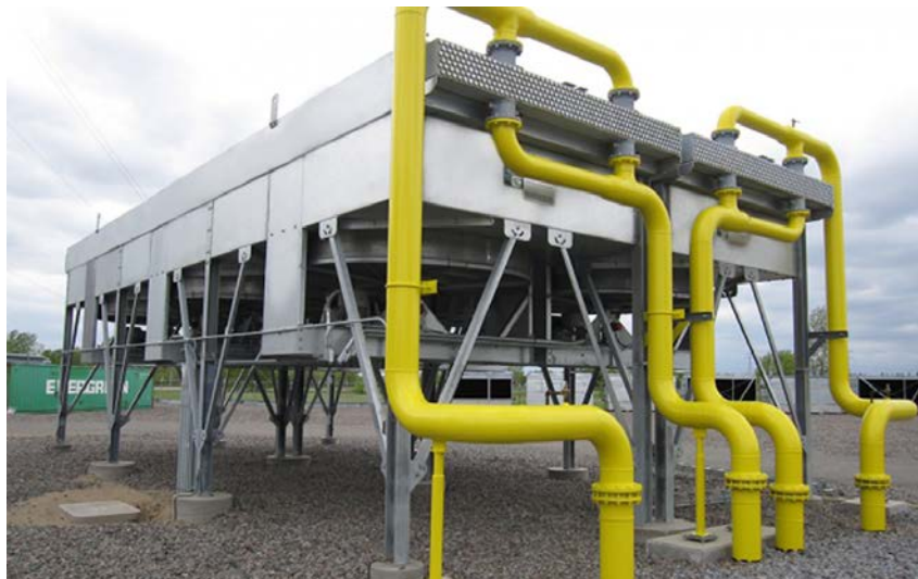
Figure.II.4 : Échangeur de chaleur [165]
