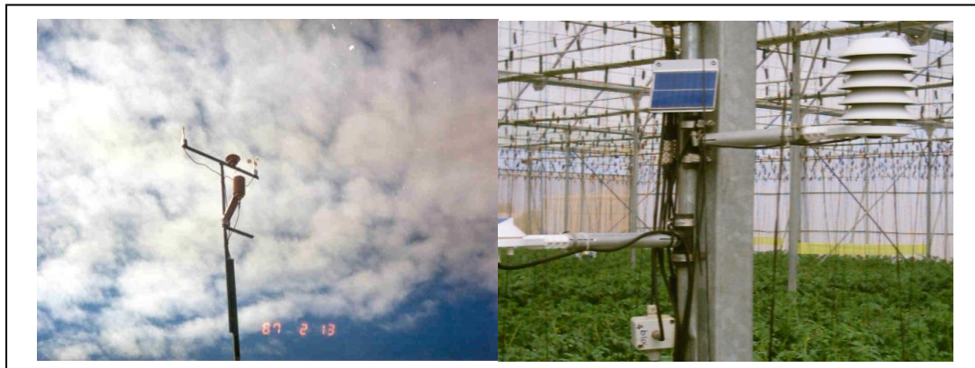
Figure 2. 4 : Stations météorologiques extérieure et intérieure
