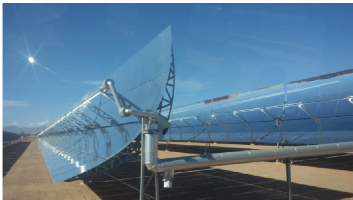
Figure I-5 Centrales à capteurs cylindro-paraboliques installée à Ouarzazate
