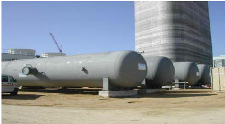
Figure II-17 Quatre cuves de stockage de vapeur de PS10 (Lomonaco.A 2015)
