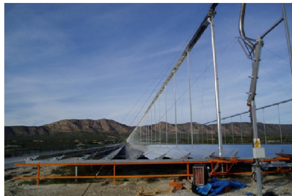
Figure I-4 Technologie du concentrateur à miroirs de Fresnel Installée à la Plateforme Solaire d'Almería en Espagne (Xavier Py 2013)
