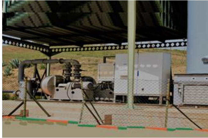
Figure III.9 : Station de soutirage de la décharge contrôlée de Fès.
