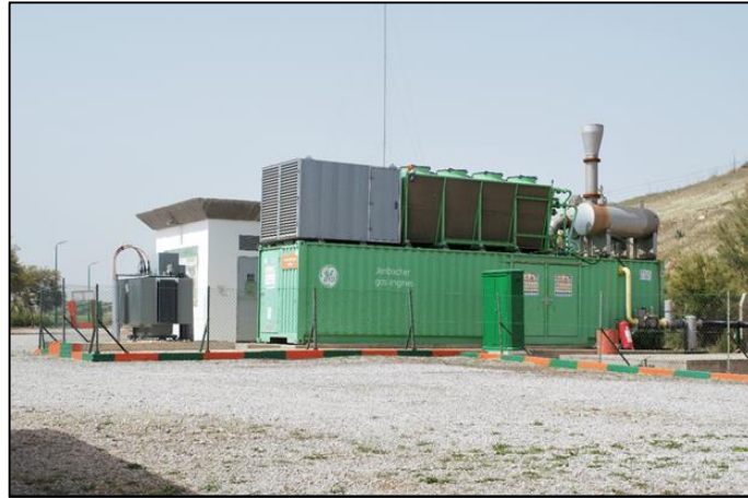
Figure III.7 : Générateur électrique de 1063 kW de l'unité de valorisation du biogaz à Fès.
