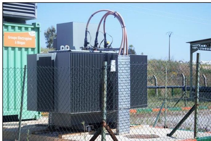
Figure III.8 : Transformateur de tension électrique de la décharge contrôlée de Fès.
