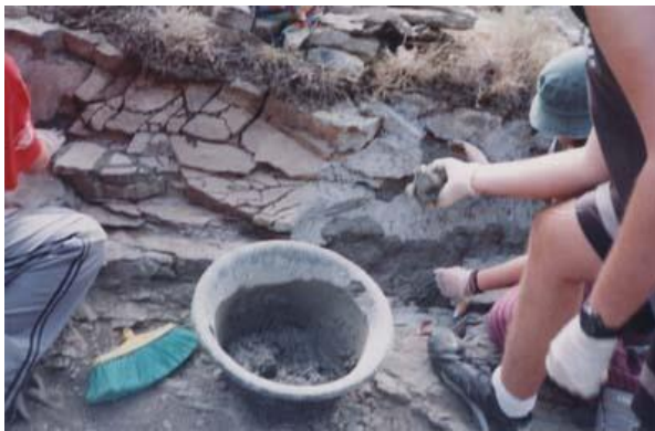
Figure 69 : Colmatage par ciment, la Rioja.
