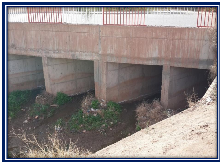
Photo 30 : Fossé Sud-Ouest : Pont de la route Mhamid-Agafai - Laisse de crue
