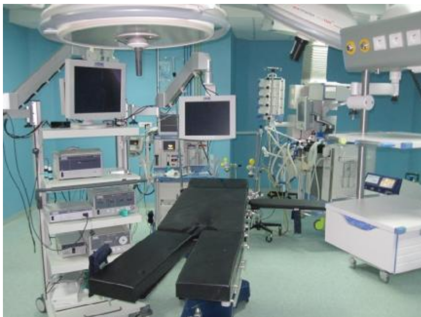
Fig. 36 : Equipement du Bloc opératoire du CHU Hassan II – Fès.
