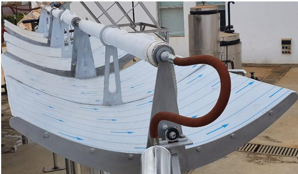
Fig. 3 : Le capteur cylindro parabolique développé et installé au niveau du prototype Bituma.
