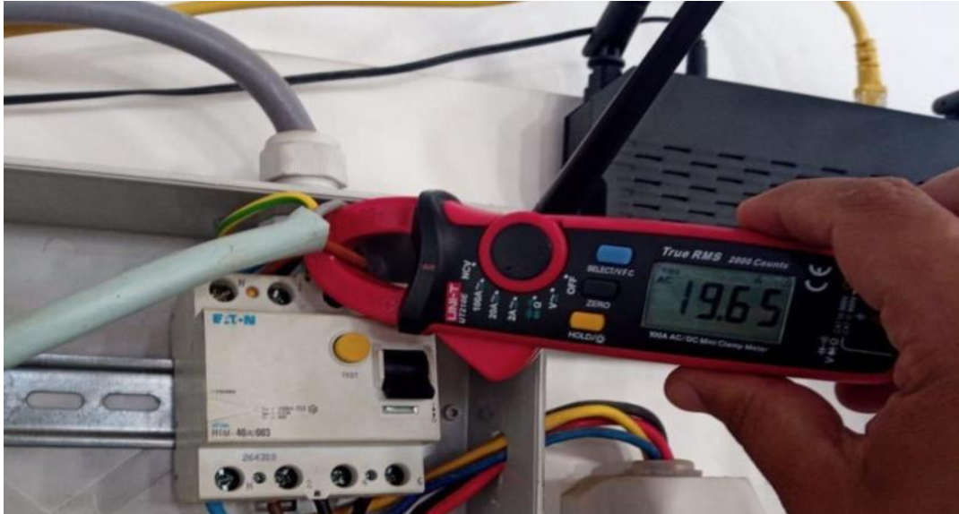
Figure IV-21: Mesure du courant de charge électrique de la chaudière électrique
