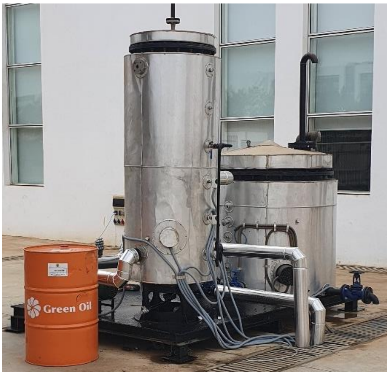
Figure IV-11: Remplissage du réservoir par l'huile thermique Green Oil
