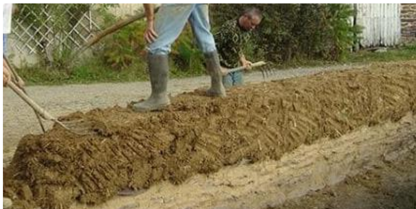
Figure 1. 2: Construction d'un mur en terre crue avec la technique de la bauge [33]
