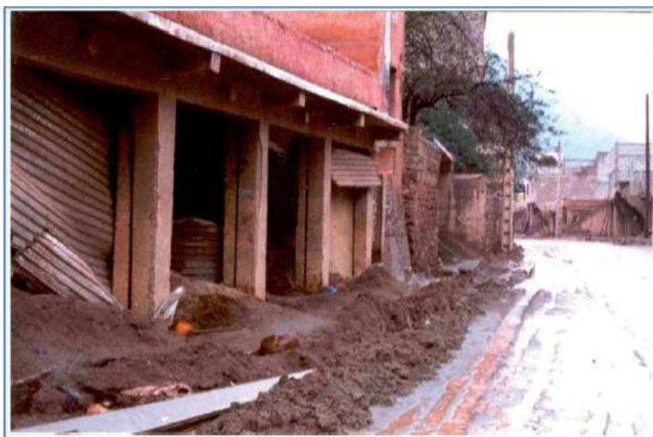
Photographie I.4 : Commerces et habitations emportés par la crue du 17 août 1995 (ELMEHDI SAIDI 2010).
