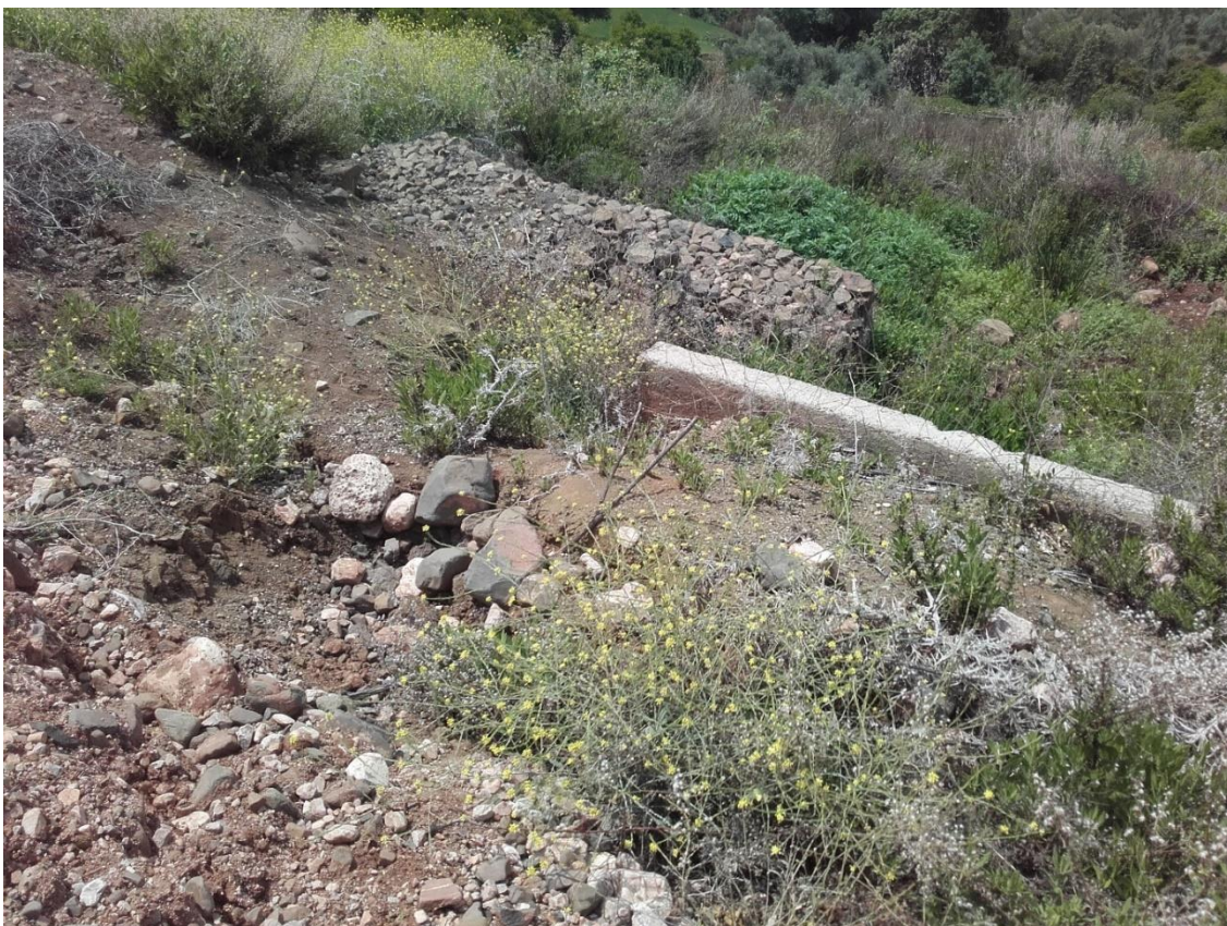
Figure VI. 33 : photo d'un exemple de route détruite à cause du glissement de terrain
