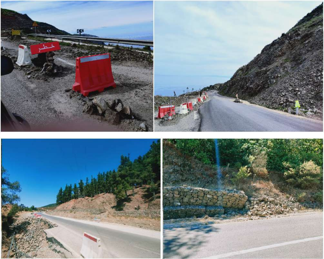
Figure 4 : Dégradation des routes à cause des instabilités de terrain
