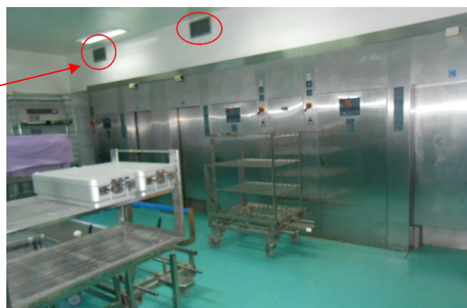
Figure 24 : Zone de conditionnement 1 (ZC)
