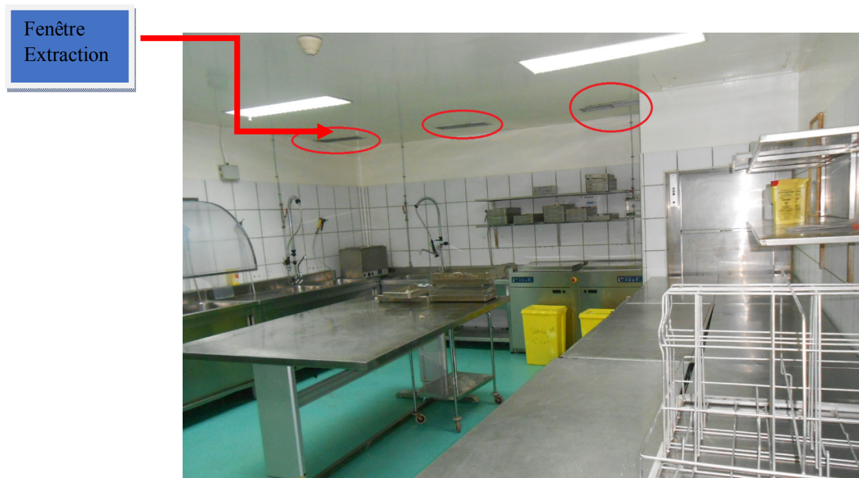
Figure 22 : Zone de lavage avec trois fenêtres Extraction (ZL)
