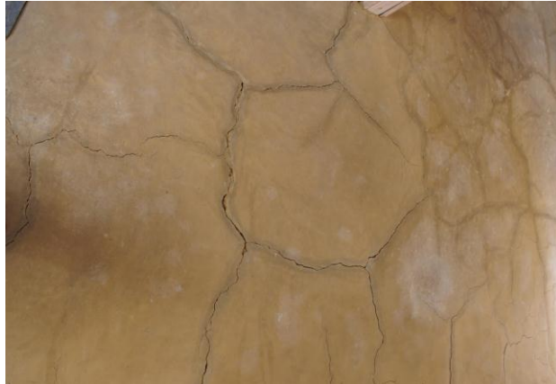
Figure 3 : Photographie d'une fissuration du retrait d'un enduit à base de chaux.
