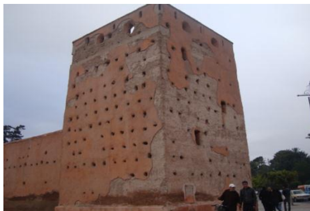
Figure 4 : Photographie d'un exemple de cloquage d'un enduit.
