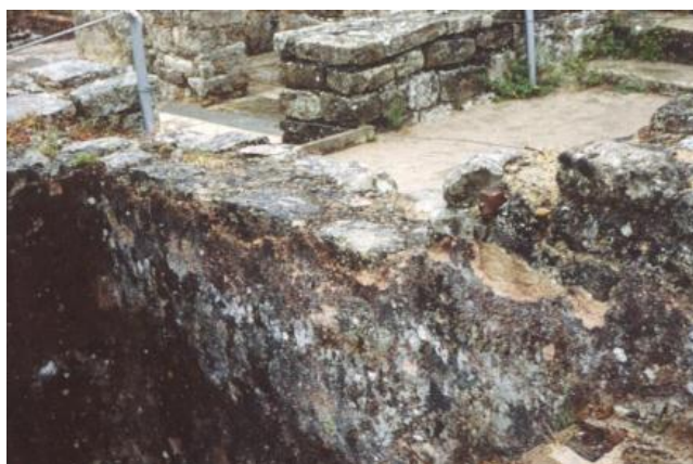
Figure 5 : Photographie d'un exemple de croûte noire sur enduit à base de chaux.
