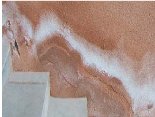
Figure 6 : Photographie d'un exemple d'efflorescence d'un enduit à base de chaux.
