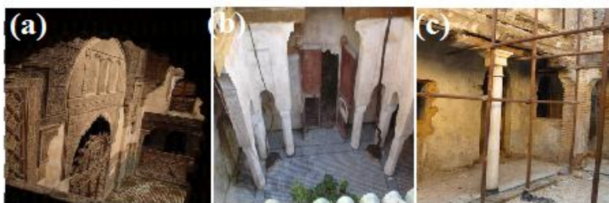
Figure 12 : Quelques exemples de la dégradation des œuvres monumentales de la Médina de Fès. a) Médersa Sahrij. b) Ancienne maison de la Médina de Fès. d) Médersa Sbaïyine.
