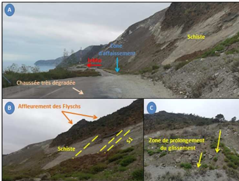
Figure 44 : Etat de la section instable S3 (aout 2022)
