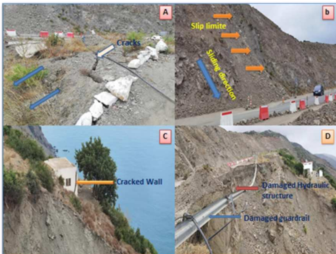
Figure 76 : Etat des dégradations dans la zone 2 de la section S6 (aout 2022)
