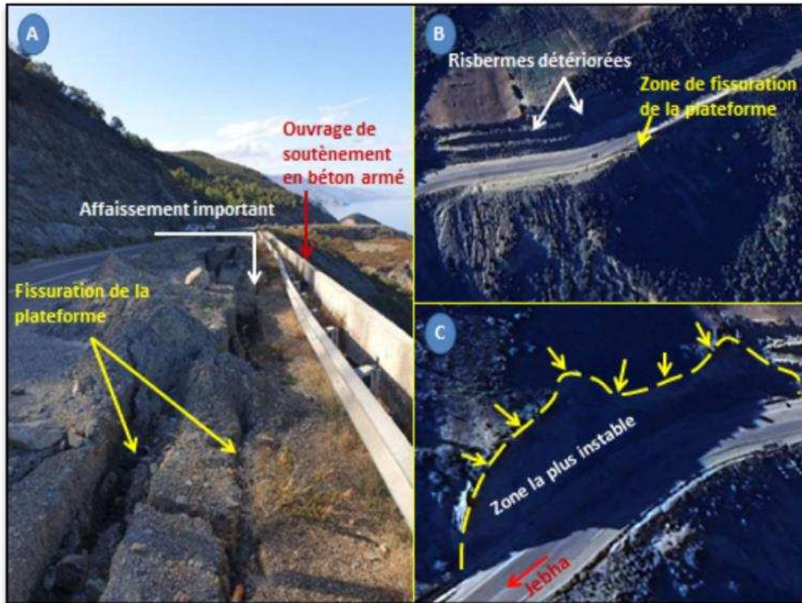
Figure 70 : Etat des lieux de la section instable S10 (mars 2023)
