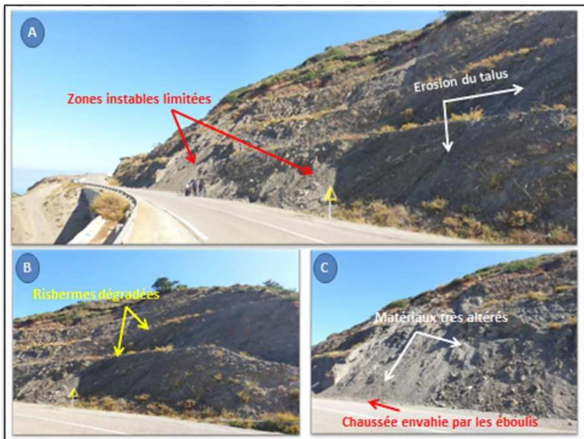
Figure 60 : Etat des lieux de la section instable S7 (juin 2021)
