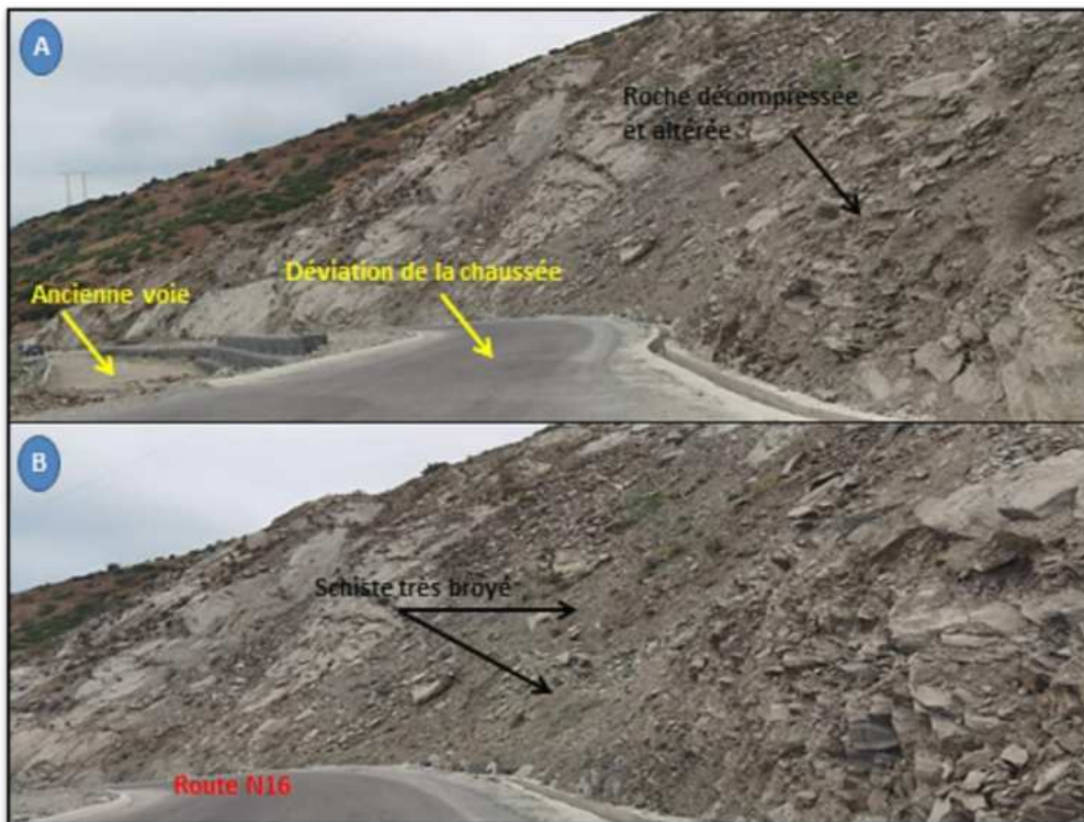
Figure 52 : Etat des lieux de la section instable S4 (juin 2021). A) Déviation de la voie dans le sens du talus. B) Roche très altérée et décompressée
