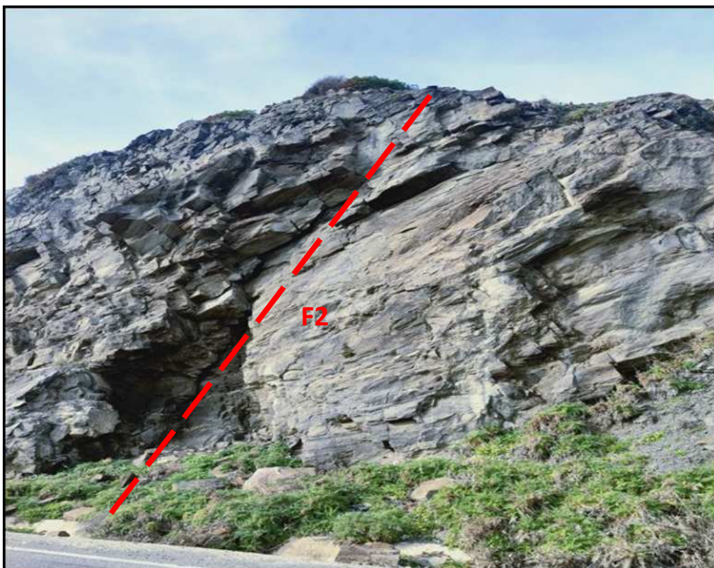
Figure 6 : Faille type F2 observée avant Amter en venant d'Oued Laou. F2 est orientée dans le sens de l'extension de la faille de Jebha. Le schiste est très fracturé dans ce talus
