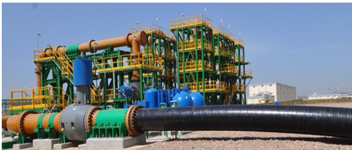
Slurry Pipeline de l'OCP
