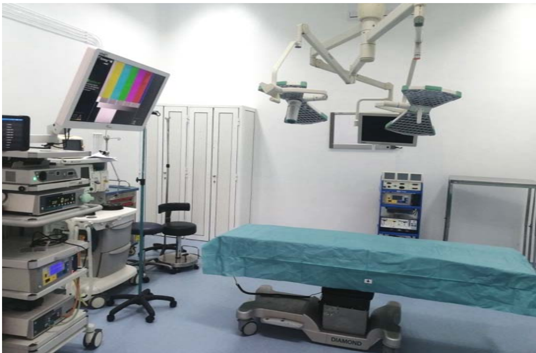
Figure N°24 : La salle d'opération. (Iconographie du service de chirurgie générale du 1 er CMCdes FAR Agadir).
