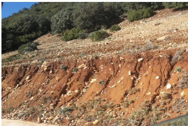
Photo 3: Milieu stable menacé par les conséquences de l'érosion linéaire généralisée en l'absence de sa protection à Naour.
