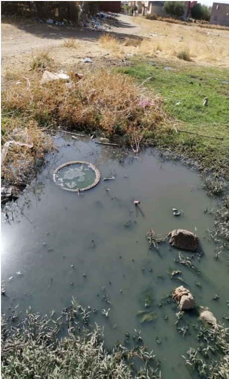
Photo1 : Pollution dans les quartiers où il y a une insuffisance des réseaux d'assainissement liquide.
