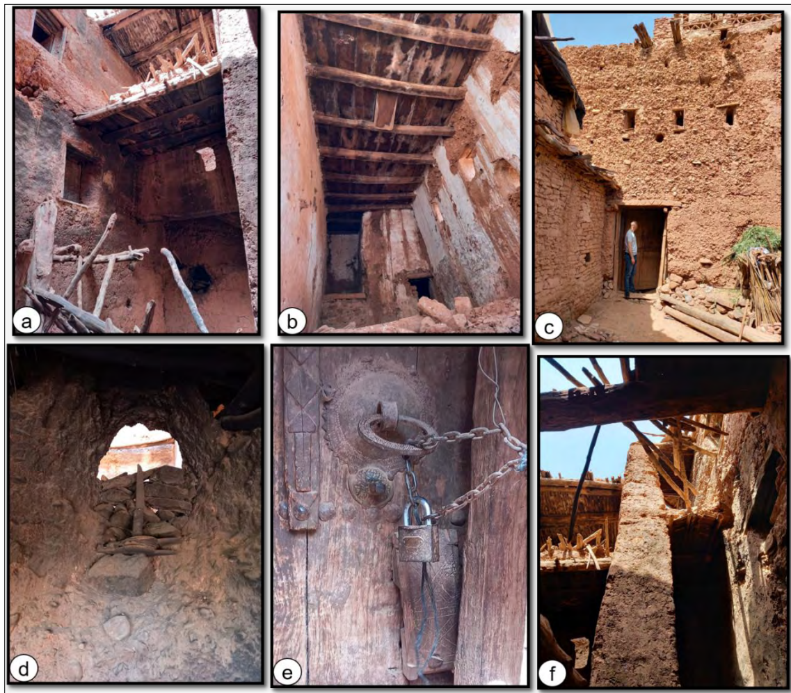
Fig. 76 : a, b et f) Etat de dégradation de l'intérieur du grenier Ait Abdoun ; c) Dégradation de l'extérieur ; d) Le trou dû au projectile du canon de l'ennemi ; e) Porte fermée d'une chambre à l'intérieur du grenier.
