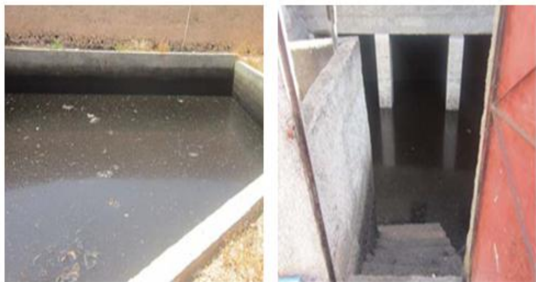
Figure I-3: Bassins en béton pour le stockage des margines
