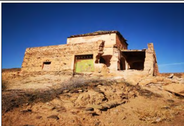
Erosion aux alentours de la Zaouïa
