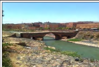
Le pont de Mly Smail en 2010, destruction partielle
