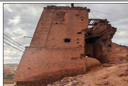
Destruction presque totale du coté Sud de la Kasbah
