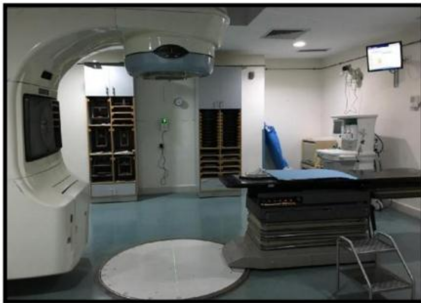
Figure 46 : Accélérateur linéaire, service de radiothérapie de l'hôpital d'oncologie, CHU HASSAN II, Fès
