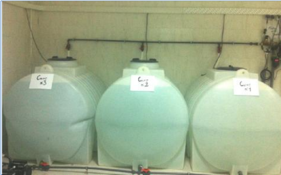
Figure 30: Cuves de stockage du pré traitement
