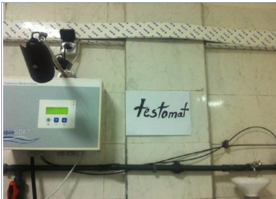
Figure 35 : Testomat en aval des adoucisseurs avec site de prélèvement de l'eau adoucie
