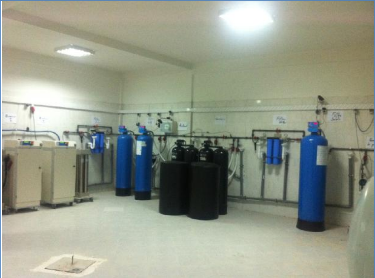
Figure 28 : salle de traitement d'eau pour HD du centre des maladies rénales (vue d'ensemble)
