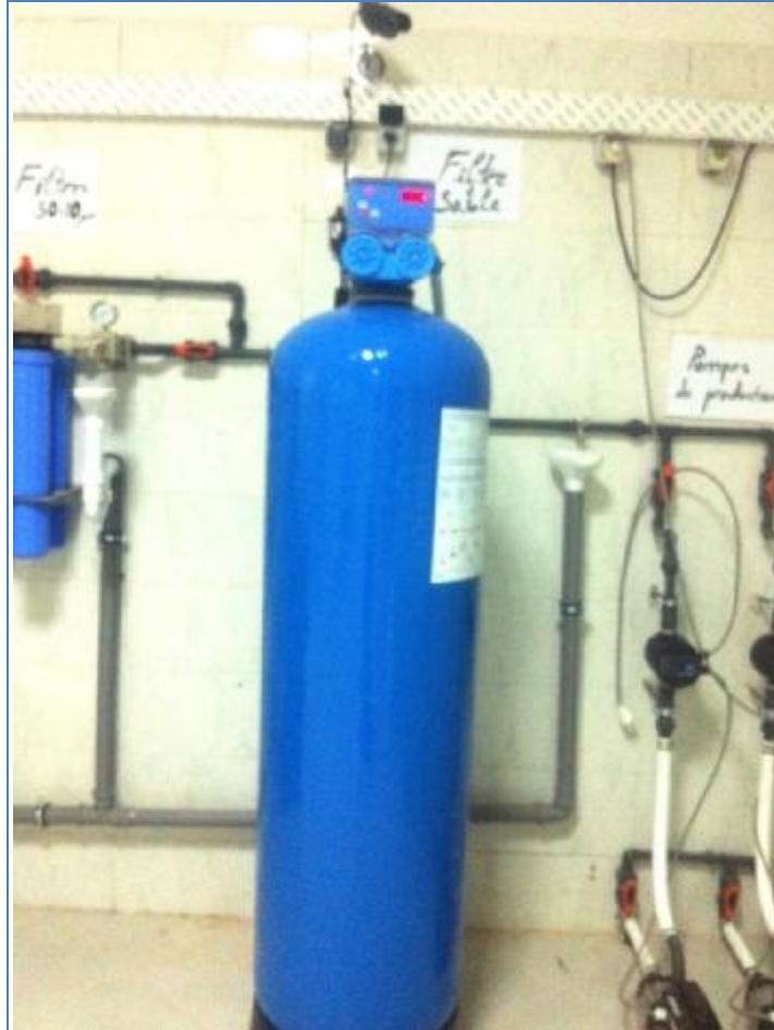
Figure 32 : Filtre à sable
