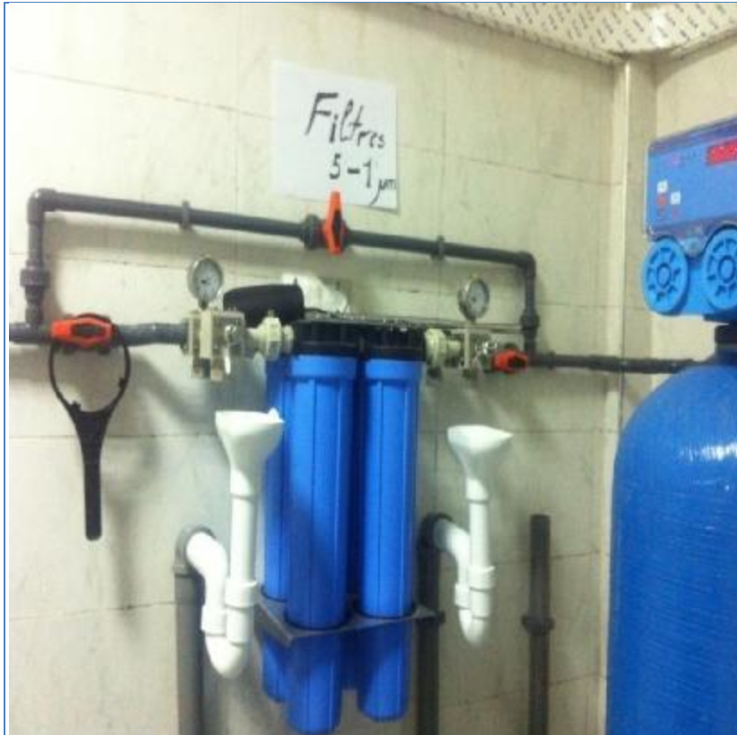
Figure 37 : deux paires de filtres 5 et 1 \mu\text{m} en aval des charbons actifs
