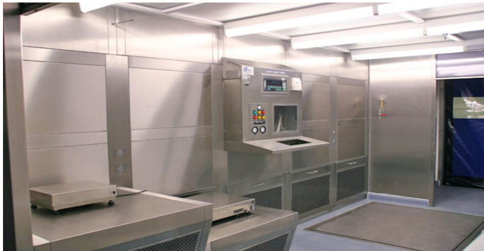
Figure 18: Exemple de finition dans une salle de pesée des matières premières.
