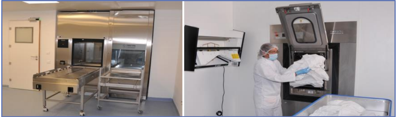
Figure 72: Zone propre de stérilisation et zone propre buanderie (175).
